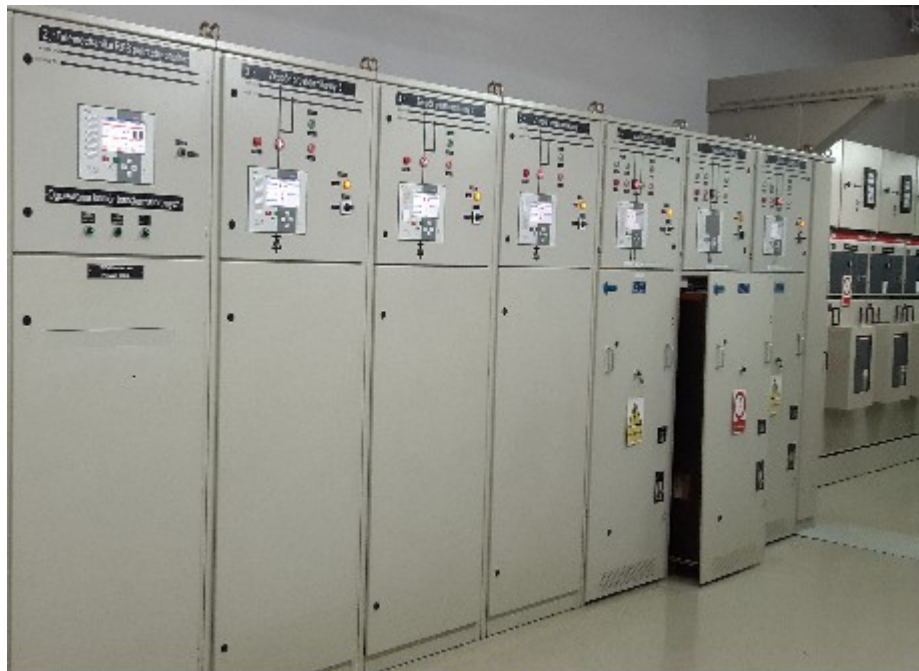
Fot 4: Rozdzielnica prądu stałego ze sterownikami E1000
